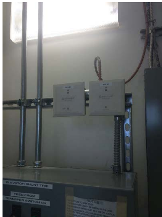
Heat Detector Modules
